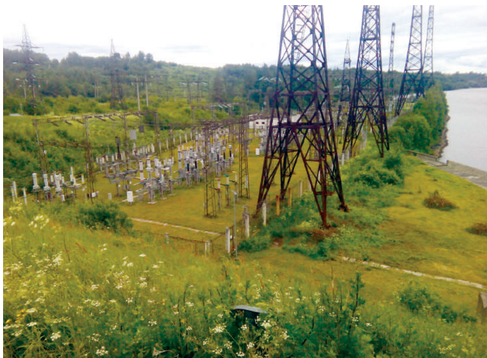
Участок с линиями электропередач при Верхнесвирской ГЭС
