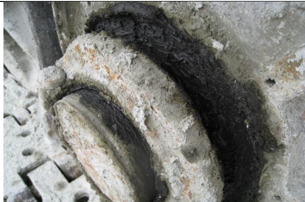
Комментарий: ослабление крепления хомутов опорных катков (зазор 30-50 мм)
