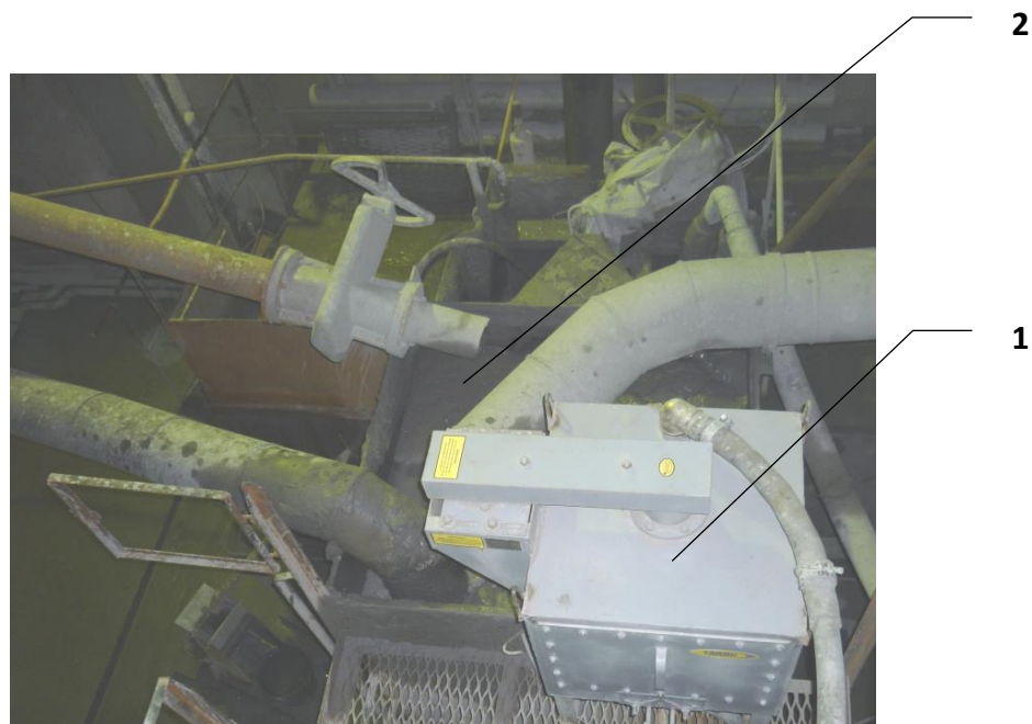
Рисунок 7.14 – Станция опробования СОП-1-325-08П для опробования отвальных хвостов с принудительной транспортировкой возвратного потока: 1 – модуль пробосократительный; 2 – зумпф дренажного насоса
