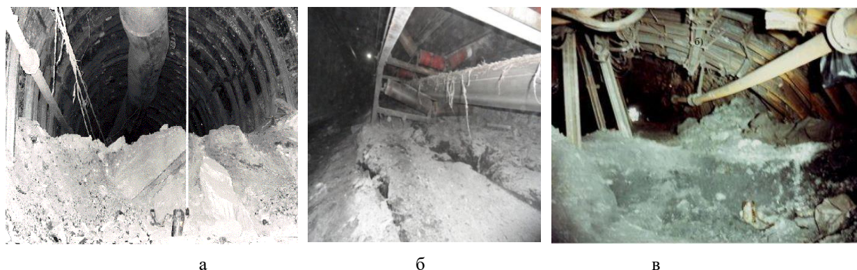
Рис.4–Деформации выработок по середине почвы (а), по бокам (б), контуров (в) выработок
