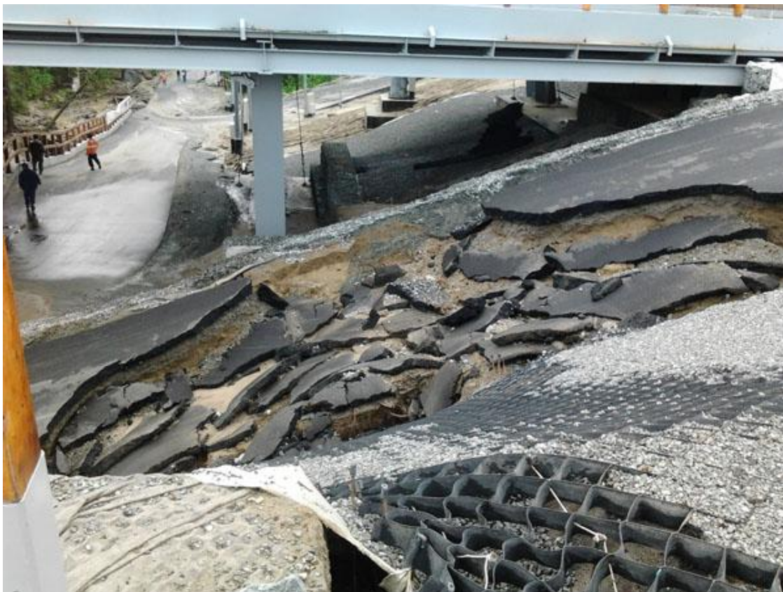
Рисунок 1 – Разрушения на биатлонной трассе (скоростной спуск)
