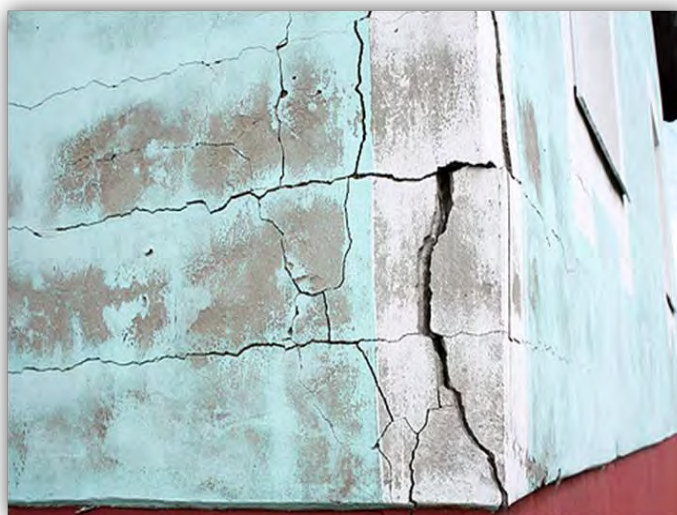
Рисунок 1 –Зияющие трещины блоков
