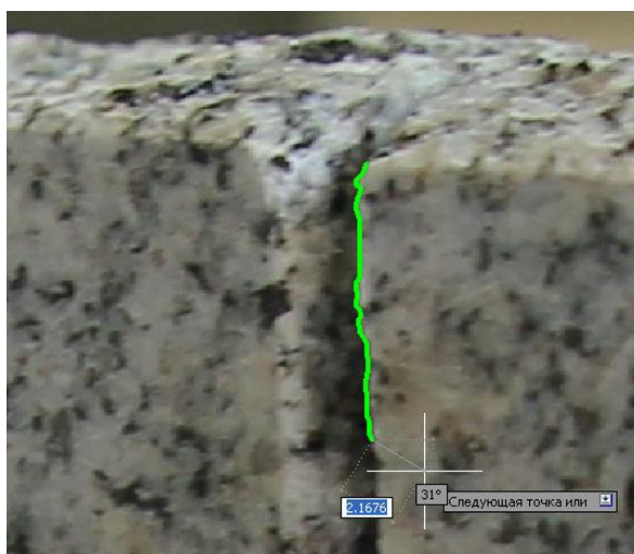
Рисунок 1 - Наложение полилинии на контур трещины
