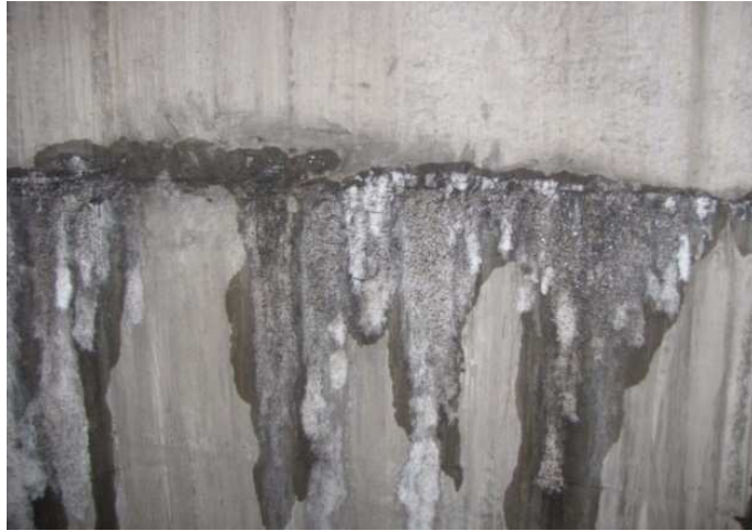
Рис. 5. Пример наличия протечек и образования высолов в монолитной железобетонной обделке ствола шахтной вентиляции
