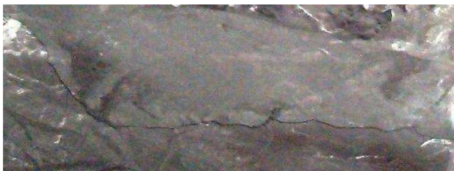
Рис. 2. Фотография трещины на стенке квершлага
