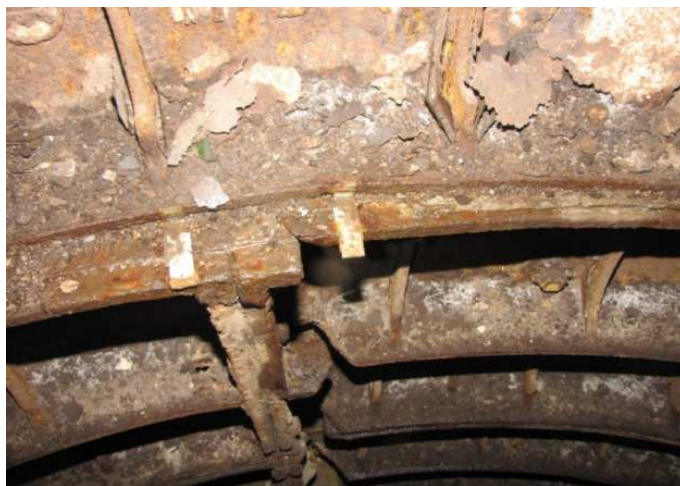
Рис. 8. Пример наличия излома тюбингов чугунной обделки ствола шахтной вентиляции со смещением внутрь ствола
