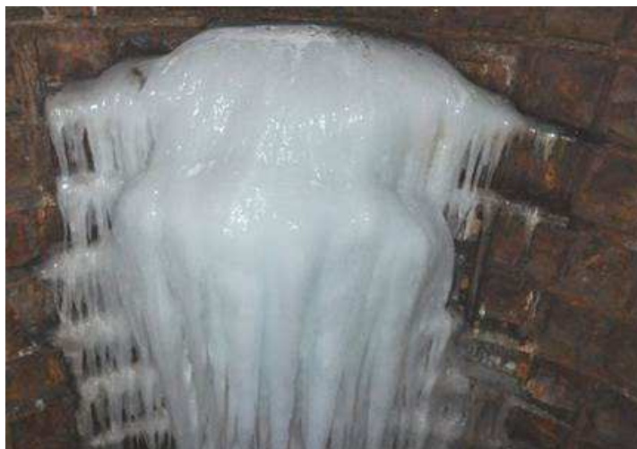
Рис. 4. Пример обледенения участка чугунной тюбинговой обделки ствола шахтной вентиляции
