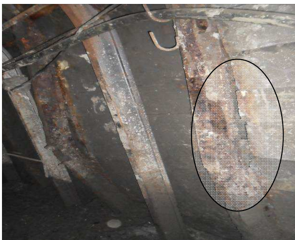
Рис. 1. Характерный вид нарушений стоек крепи
