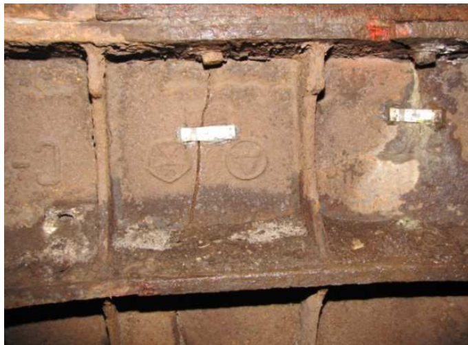
Рис. 6. Пример наличия трещин в спинке, ребрах и бортах тубинга чугунной обделки ствола шахтной вентиляции. Установлены маяки для контроля за динамикой раскрытия трещин
