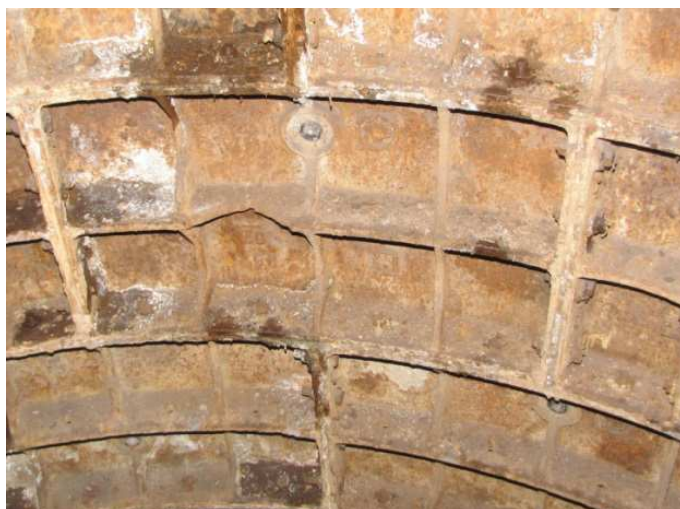
Рис. 7. Пример наличия скола части радиального ребра тубинга чугунной обделки ствола шахтной вентиляции
