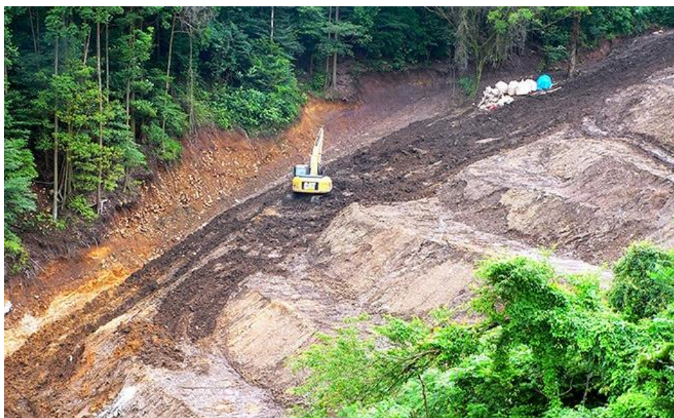
Рисунок 1 – Искусственная многоярусная насыпь на месте будущего оползня, 8 июля 2010 год
