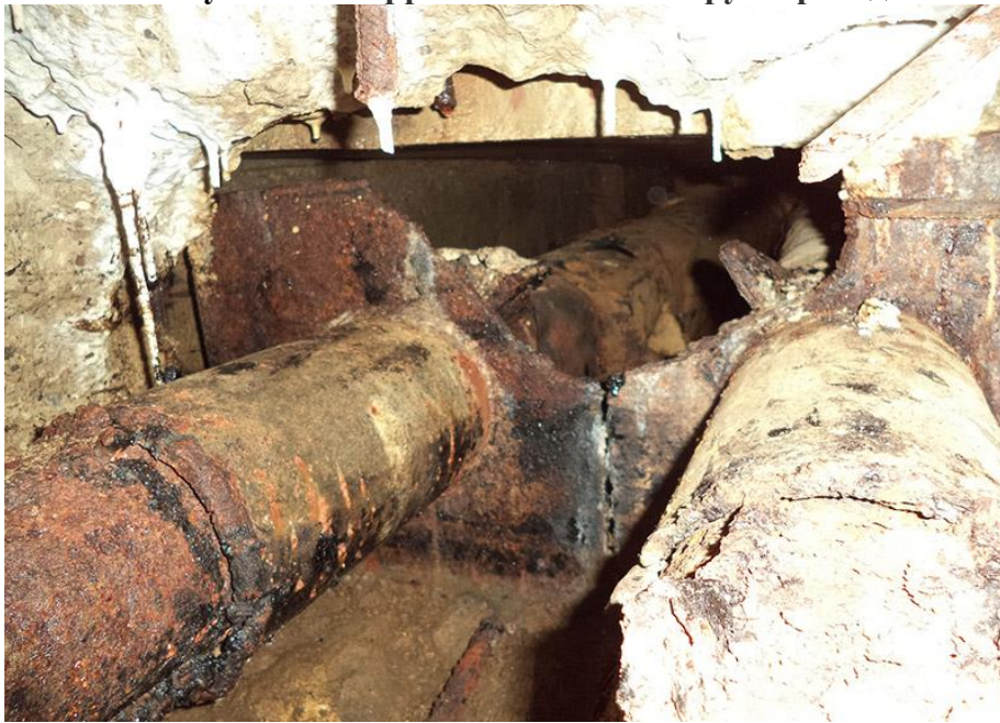
Рисунок 2 – Коррозионный износ трубопровода
