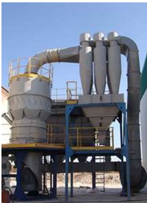
Рисунок 1 – Общий вид измельчительного комплекса КИ ЗАО «УралОмега» Результаты измельчения оценивались по распределению частиц по размерам, полученных на лазерном анализаторе Mastersizer 2000.
