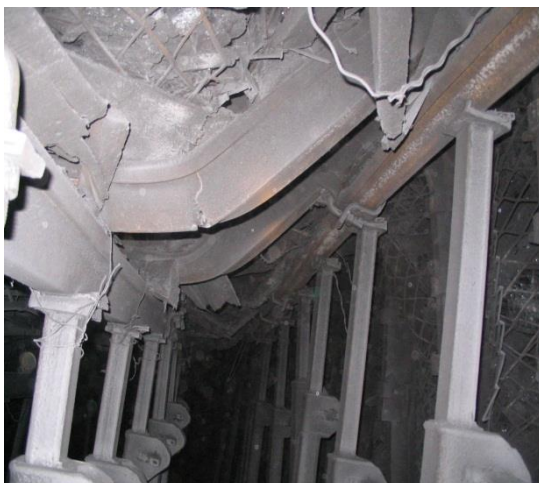
деформация (верхнего крепления)
